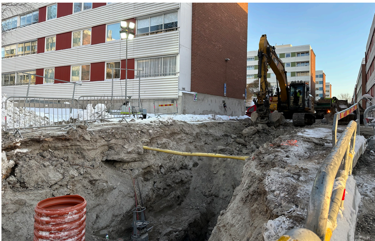
Ett oplanerat och akut behov av vattenledningsbyte på Centrumområdet pågår hösten 2022 och våren 2023.
